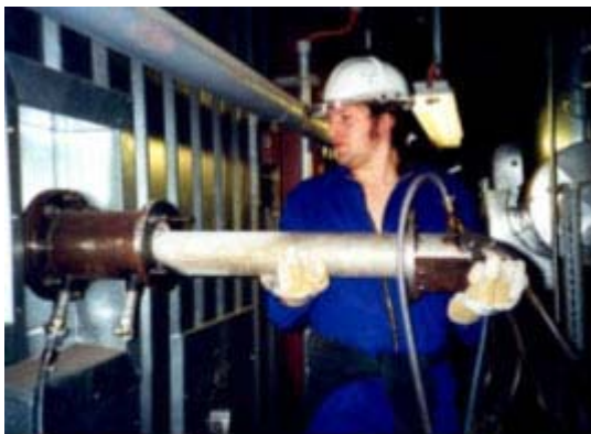
Einbau einer Spezialoptik des In-situ-Diodenlaserspektrometers zum Nachweis von Wasser und Sauerstoff in einem 600 MW Kohlekraftwerk
